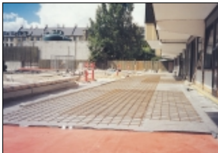
Enkadrain använt ovanpå ett parkeringshus.
